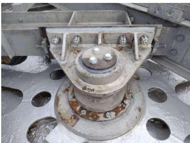
2-12 交換作業完了後の緊張滑車軸受け部 軸受け部周辺に防水コーキングを施す
