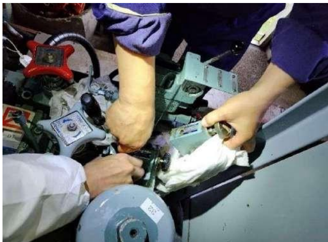
6-5 えい索緊張油圧ユニット バランシングバルブ交換作業
