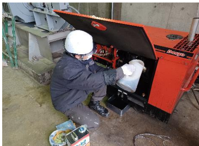
7.15 山麓予備発電機
