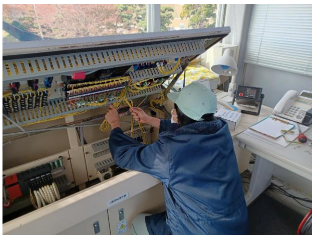
2.30 シーケンサ電源ユニット及びカード交換②
