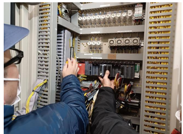
2.29 シーケンサ電源ユニット及びカード交換1①
