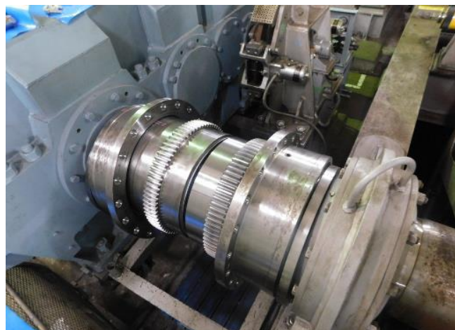
2.32 減速機出力側
