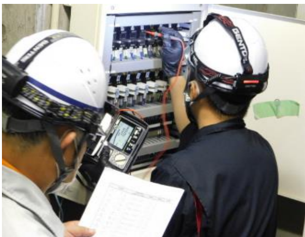
2.17 制御装置保守点検(山麓機械室保安器)
