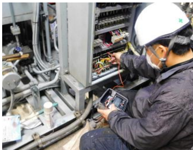
2.18 制御装置保守点検(山頂曳索緊張油圧ユニット)
