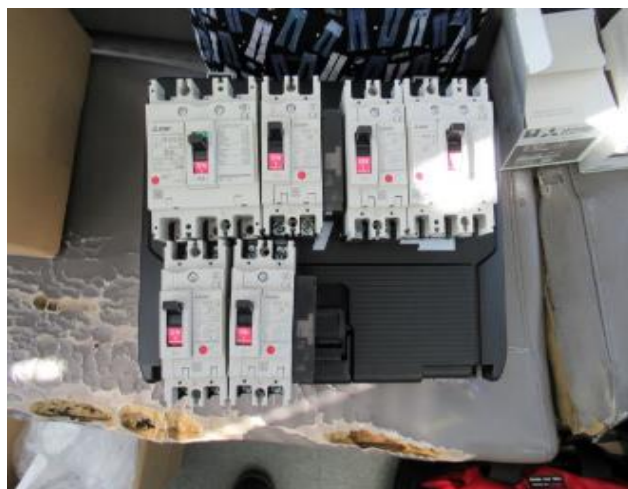
2.27.4 監視制御盤(更新用ブレーカー)
