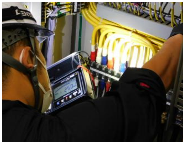
2.14 制御装置保守点検(機械室サイリスタ制御盤)
