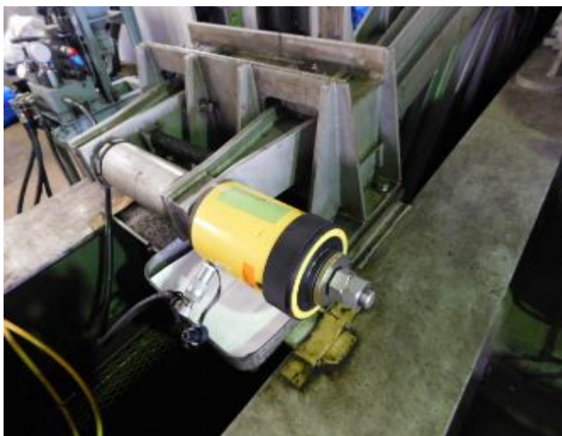
2.33 原動滑車ブレーキ油圧シリンダー交換(油漏れ)
