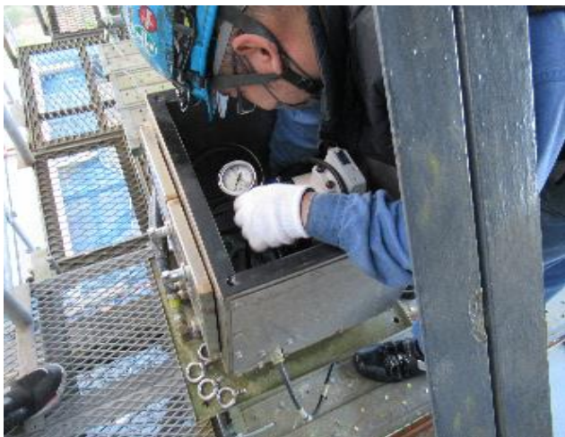
3.5 山頂せり橋油圧ユニット点検(バルブスタンド)
