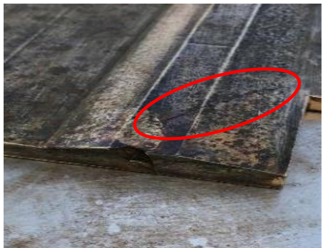
2.6 亀裂があったアクスル下部板
