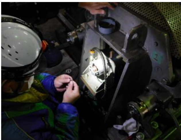
2.15 制御装置保守点検(機械室原動機)
