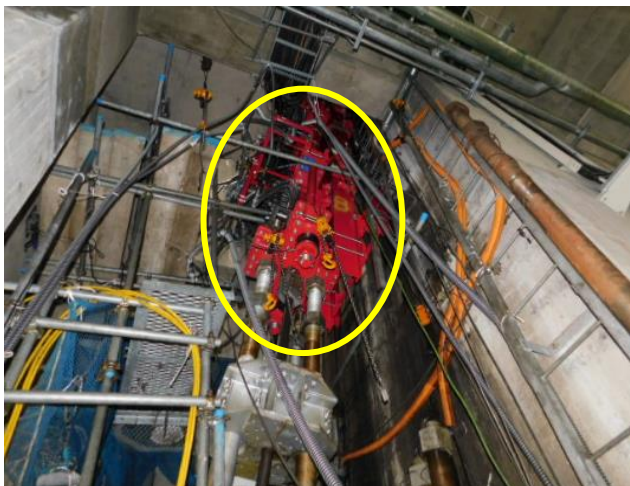
1.13 山麓側機械室の延線機
