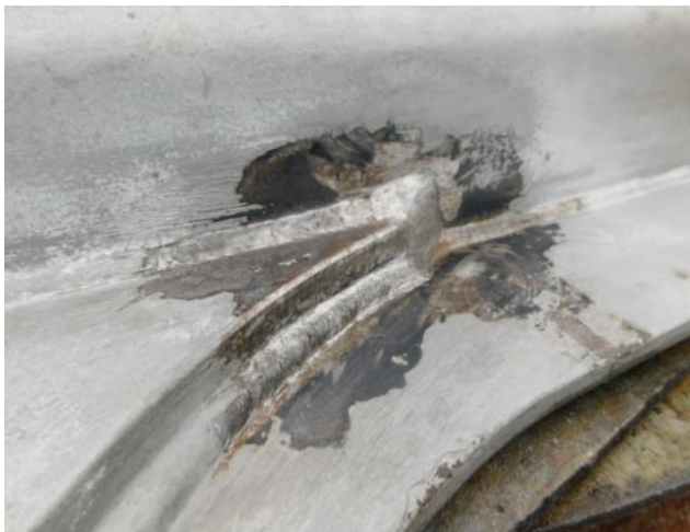
2.28.3 キャリヤ点検部の塗装を剥がした状態
