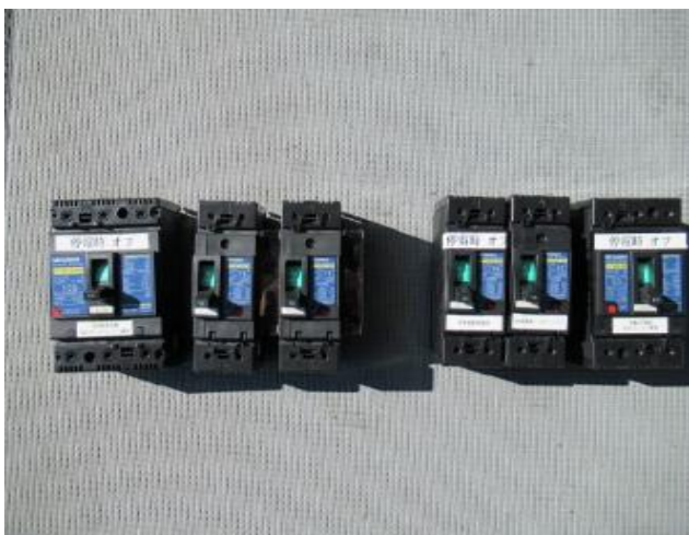
2.27.3 監視制御盤(取り外したブレーカー)
