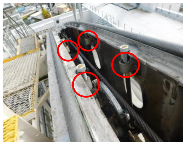
2.24 搬器押さえロッドガイド改良(ロッド破断防止対策)
