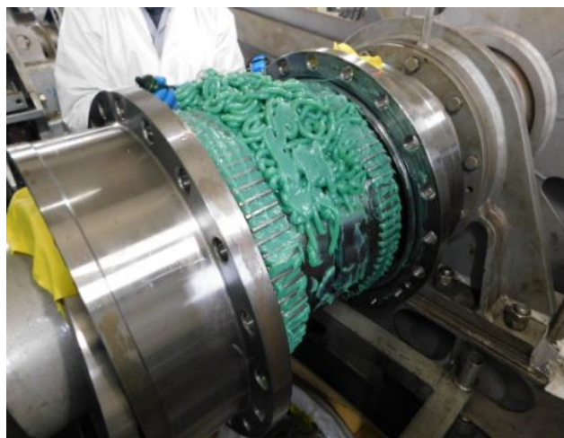
2.26 点検・清掃後給油
