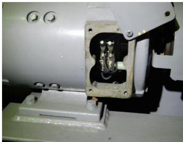
2.16 制御装置保守点検(パイロットジェネレーター)
