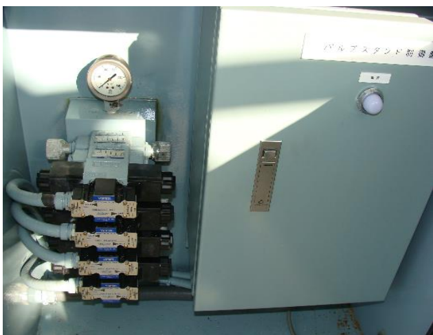
3.7 クランプ油圧ユニット点検
