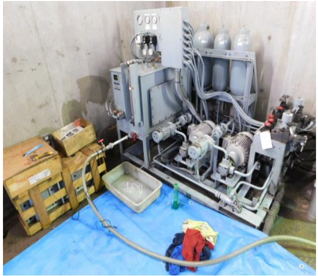
9.2 制動機オイル交換
